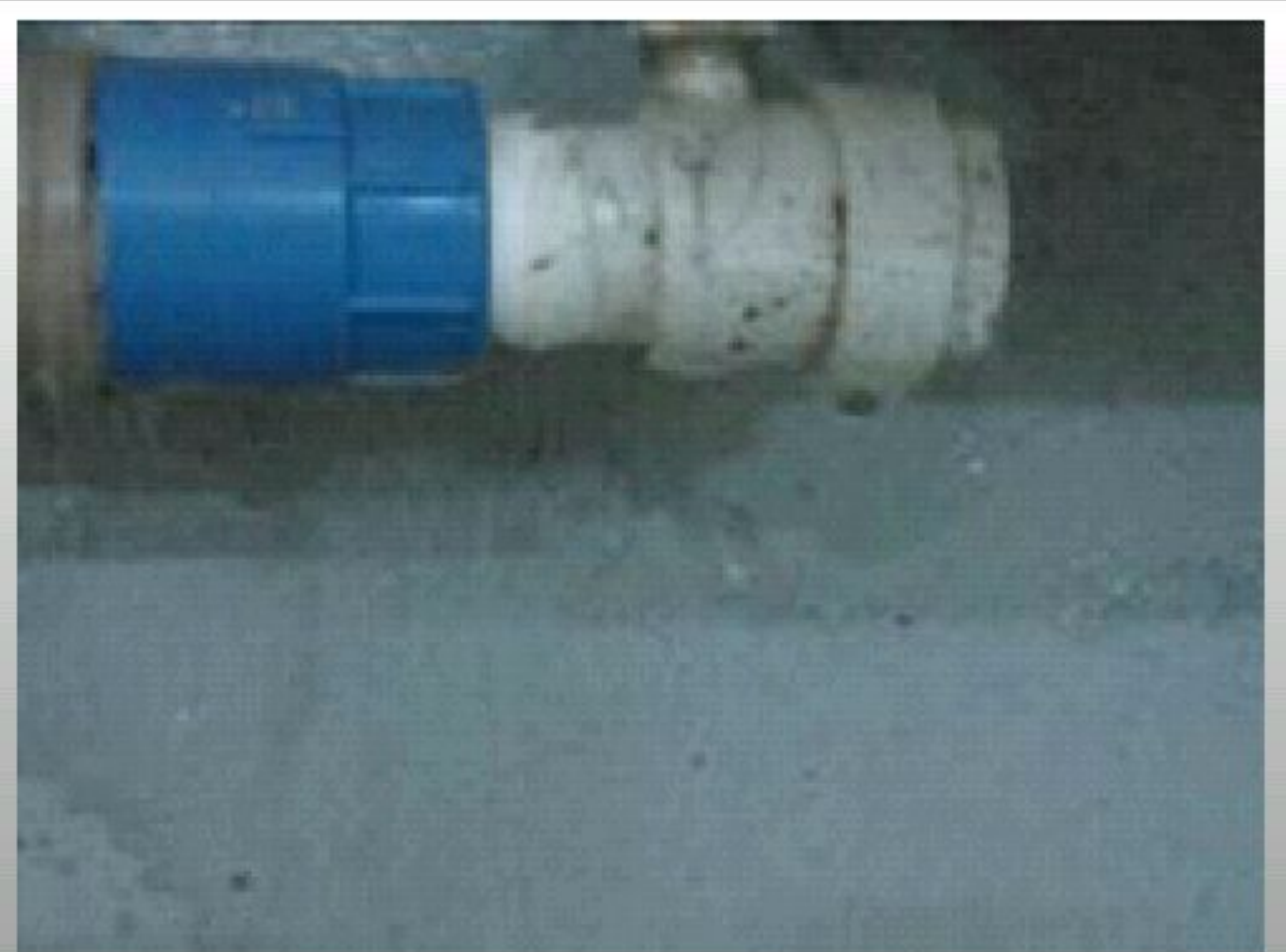
VAZAMENTO DE ÁGUA
