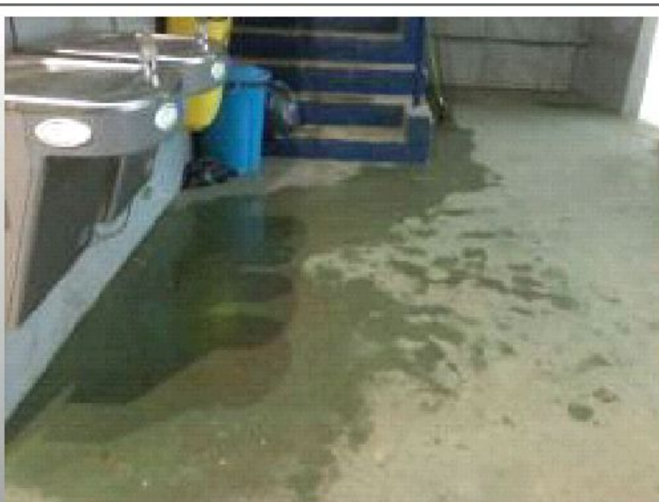
VAZAMENTO DE ÁGUA
