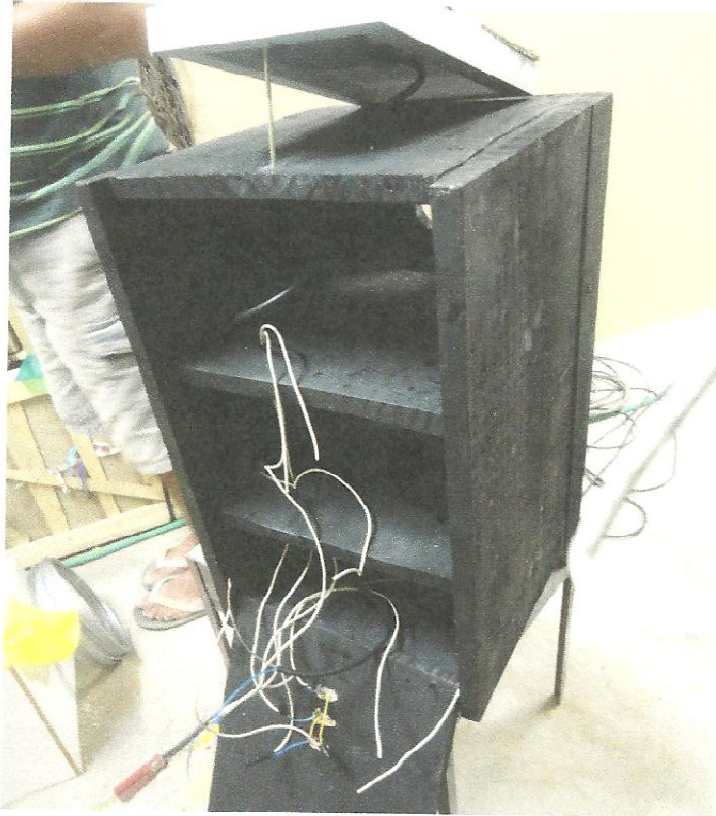
Parte elétrica do semáforo
